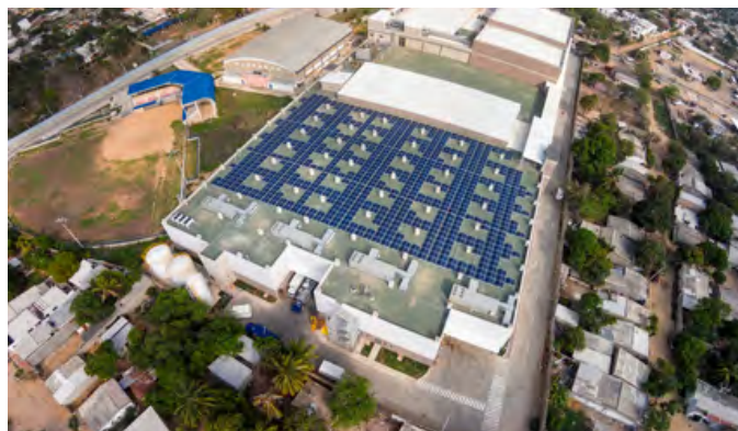
Contamos con más de 16.520 paneles solares en nuestros centros comerciales y almacenes; 5% más que en 2023 gracias a la puesta en marcha de la planta fotovoltaica en VIVA Wajira, Riohacha, Guajira
